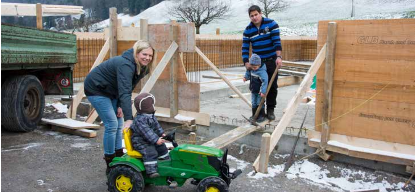
Daniela und Markus Koller aus Siebnen bauen einen Laufstall für ihre Aufzuchtrinder. Als gelernter Zimmermann kann er vieles selber machen.
